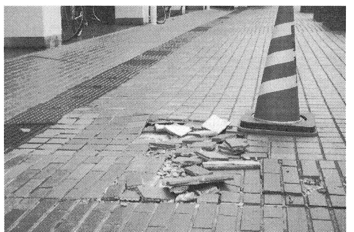
タイル破損現場 足元に注意して下さい
