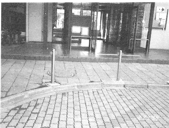
この段差をなくして下さい
