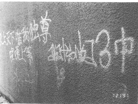
三号棟・サブステーションにはこんな落書きが
