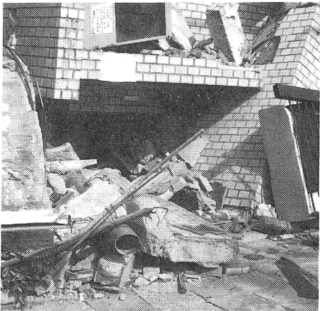
座屈した民間マンション(灘区)
